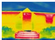
Bâtiment : déperdition énergétique
